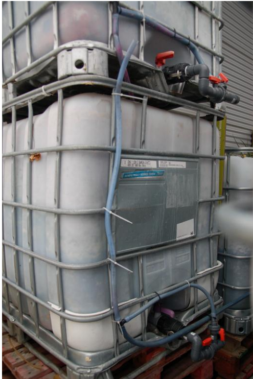
Foto 24: Beluchtingsslang op de leiding tussen twee bakken voor een betere doorstroming
