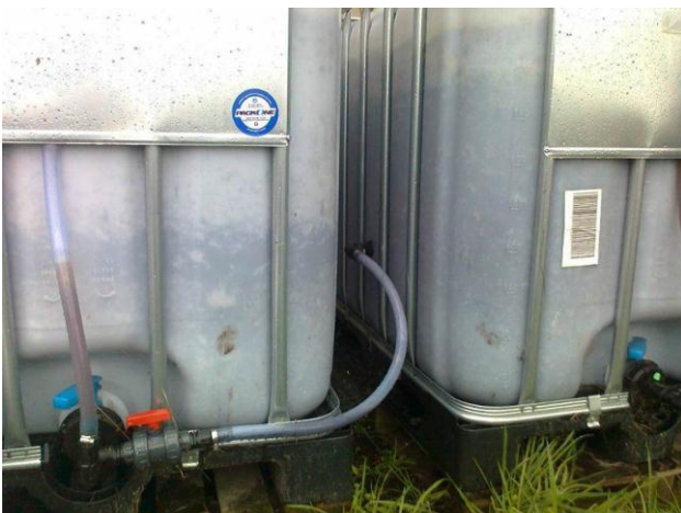
Foto 25: Verbinding tussen twee plantenbakken. Overtollig water uit de rechter bak, loopt naar de linker bak. De slang omhoog op linker bak is een beluchtingsslang.
