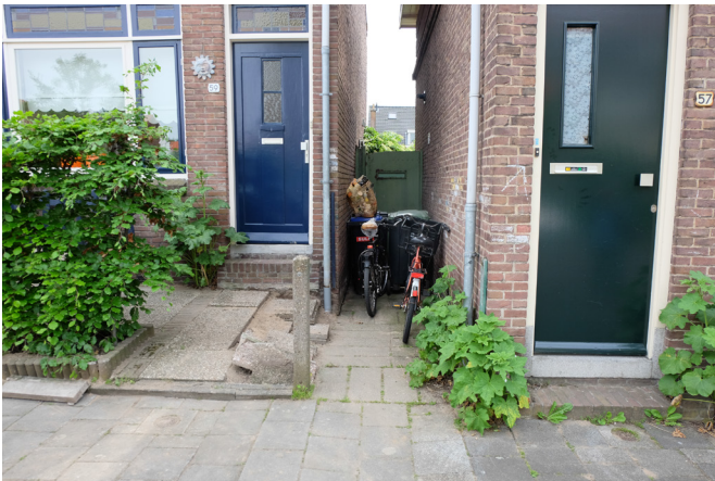
Vershil in hoogte voordeuren door bodemdaling bron: fotobankNA
