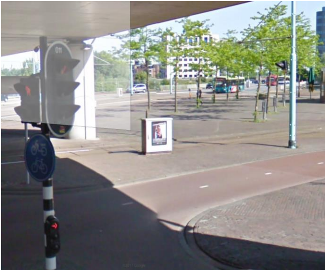
11: kast Liander elektra
