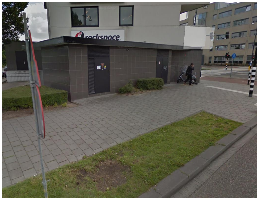
8: trafo liander elektra (inpandig)
