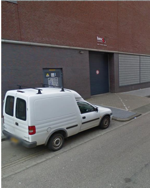
16: trafo Liander elektra (in pandig)
